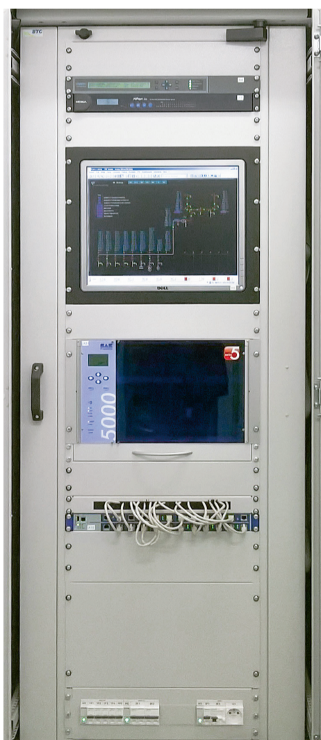
Schaltschrank mit FW-5000 und BTC Prins® HMI Arbeitsplatz
